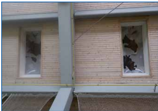
Toča je razbila tudi okna.
